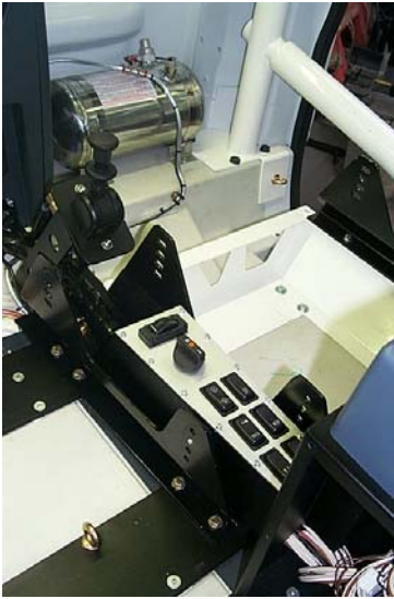
Feuerlöschanlage und Sitzkonsole
